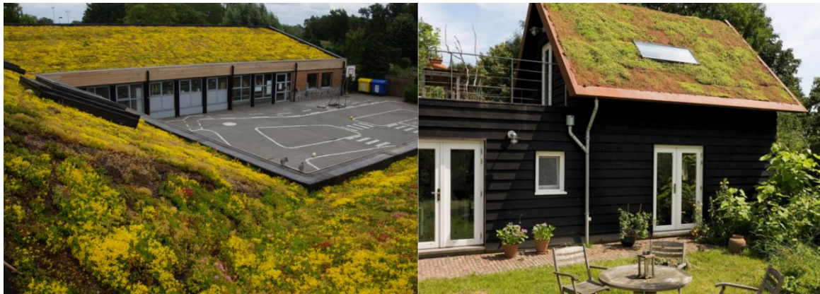
Figuur 29. Voorbeelden van een groendak. Links wordt een groendak toegepast op een groot, weinig hellend dak van de basisschool in Meerdonk Sint-Gillis-Waas. Rechts is het toegepast op het dak van een privé woning. Bron: Blauwgroen Vlaanderen.
